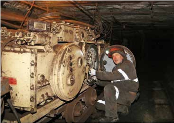
Бригадир электрослесарей участка по добыче угля Сергей Аненков производит обслуживание оборудования на распределительном пункте.
