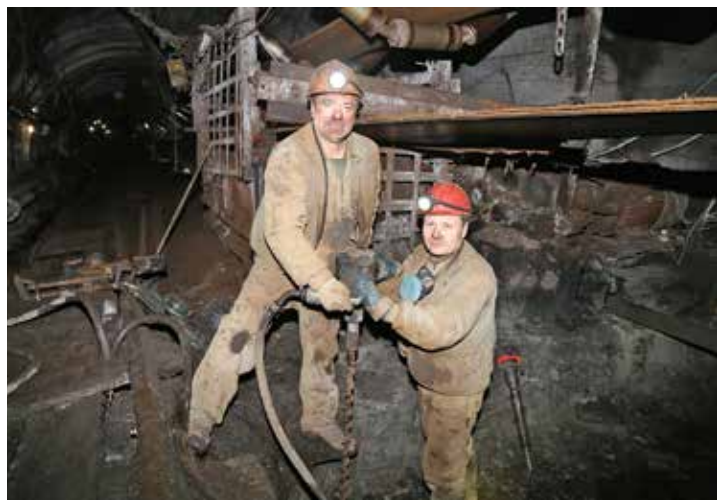
Звеньевой проходчик участка проходки горных выработок Юрий Циленко (слева) и проходчик участка проходки горных выработок Александр Перерва производят бурение анкеров под привод ленты.
