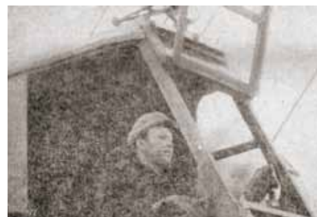
Машинист крана-экскаватора Владимир Погожев за работой на сооружении гостиницы. Без помощи стальных мускулов крана строителям пришлось бы нелегко.
