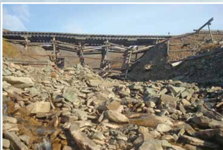
Деревянный железнодорожный мост через ручей Русанова (примерно 5-й км узкоколейной железной дороги, идущей к Груманту).
