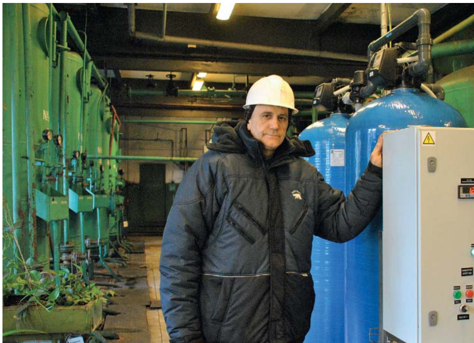
Главный механик треста «Арктикуголь» А.В. Федорович в цехе химводоподготовки баренцбургской ТЭЦ. ФОТОГРАФИЯ: НАТАЛИЯ ШМАТОВА
